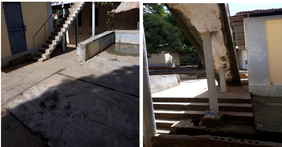
Figure 9 : Quelques infrastructures scolaires en mauvais état à réparer
