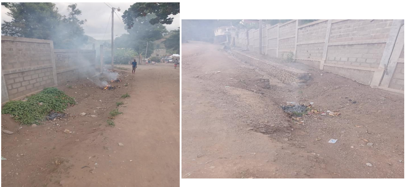
Figure 9 : Fossé existant à continuer et exigeant un ouvrage de traversée à l’entrée de l’abri Crédit photo : Glady DERESTIL (Déc. 2023)
