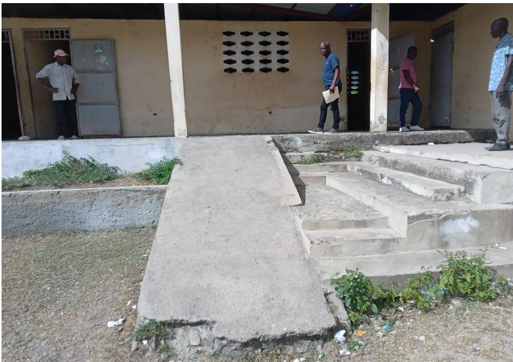
Figure 9 : Rampe en mauvais état, avec une pente non appropriée, à reprendre Crédit photo : Glady DERESTIL (Déc. 2023)
