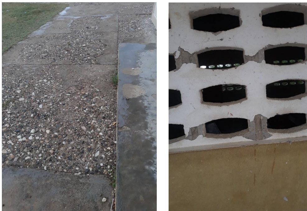
Figure 9 : Allées piétonnes et fenêtres à réparer
